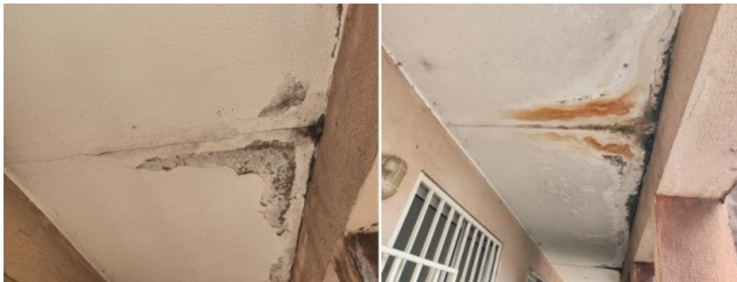
FIGURA 1: Exemplos de infiltrações de águas pluviais em juntas de dilatação de lajes do pavimento superior de blocos dos Condomínios Juarez Amorelli e Sianinha Rodrigues.
