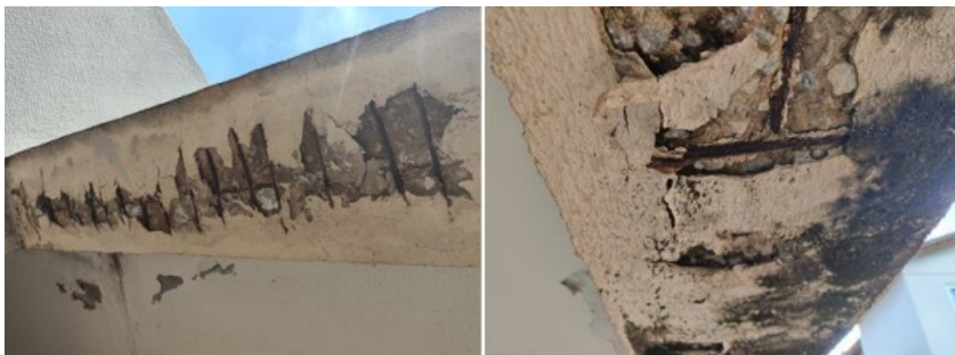
FIGURA 2: Corrosão das armaduras em vigas adjacentes às lajes do pavimento superior dos blocos dos Condomínios Juarez Amorelli e Sianinha Rodrigues.
