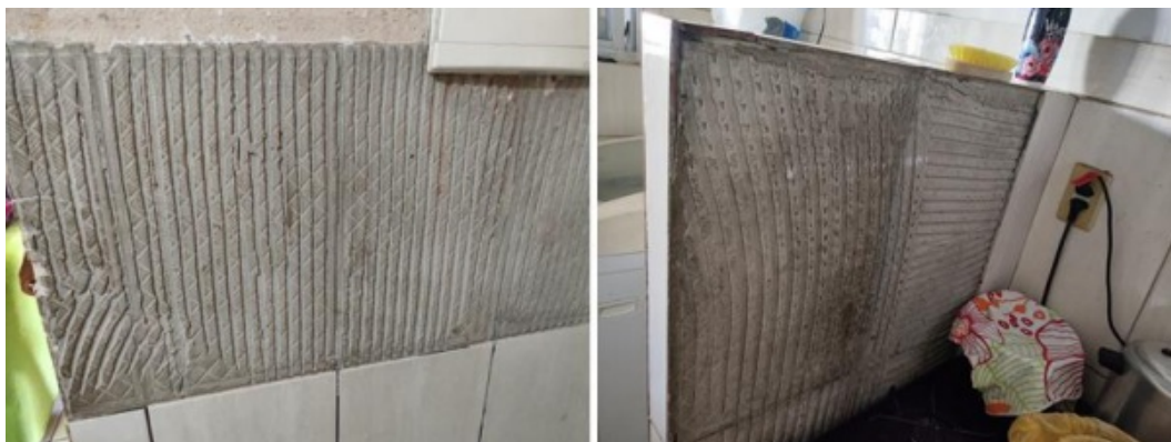
FIGURA 3. Exemplos de deslocamentos de revestimentos cerâmicos em apartamentos dos Condomínios Porto Salinas e Juarez Amorelli.
